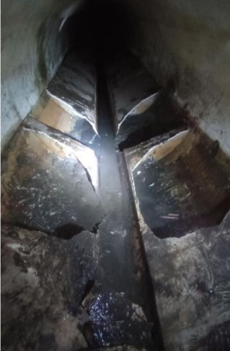
Abbildung: Schadensbild Trockenwasserrinne
