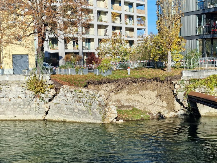
Einsturz der Mauer unterhalb des Wasserkraftwerks
