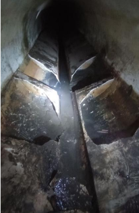
Abbildung: Schadensbild Trockenwasserrinne
