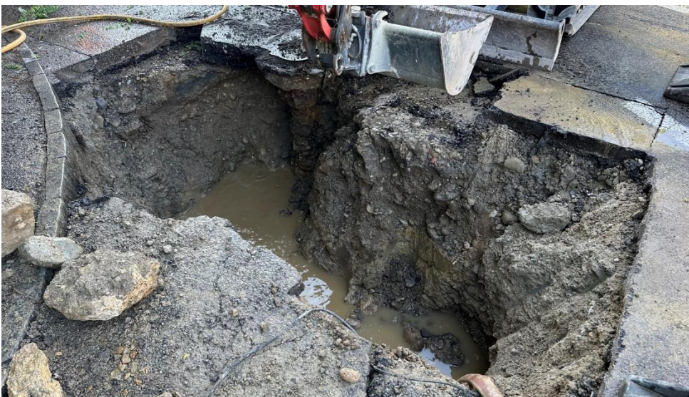
Abbildung 07: Foto Wasserrohrbruch vom 28. Juni 2025 auf der Habsburgstrasse
