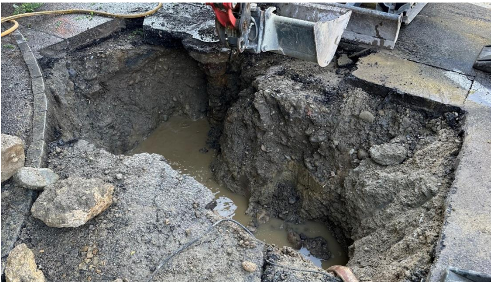
Abbildung 07: Foto Wasserrohrbruch vom 28. Juni 2025 auf der Habsburgstrasse
