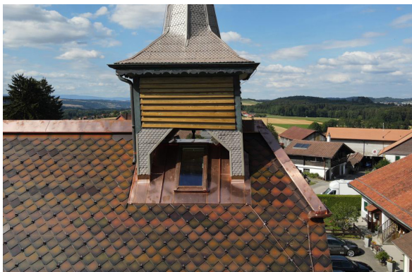
Geschuppte Solaranlagen: Gebäude im Ortskern von Ferlens
