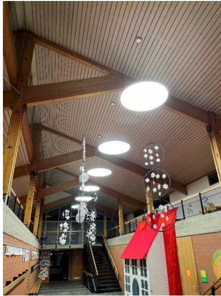
Rütenen: Umrüstung auf LED-Beleuchtung
