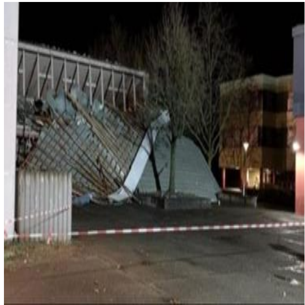
27.02.2020 Windisch, Dach Turnhalle komplett abgedeckt
