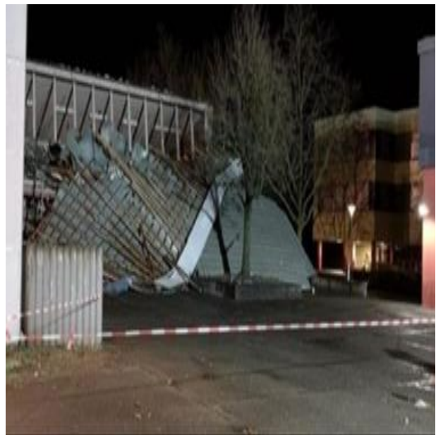
27.02.2020 Windisch, Dach Turnhalle komplett abgedeckt
