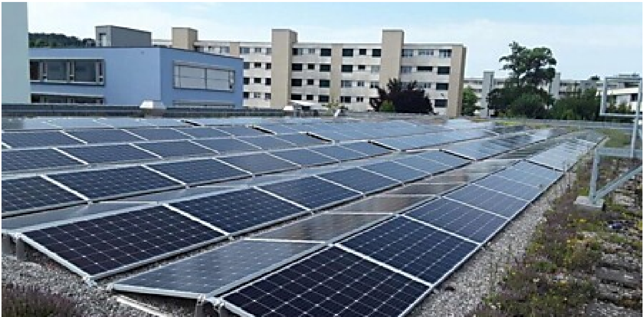
PV-Anlage Schulhaus Chapf
